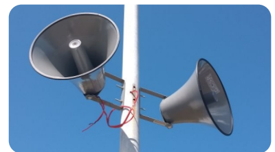
Sistema de comunicação em estacionamento - Ball - Cabo/PE
