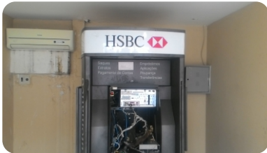
Desativação de PAB vandalizado HSBC - Pitimbu - Natal/RN
