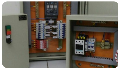
Quadros elétricos - Itaú Jaboatão dos Guararapes/PE
