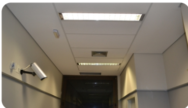
Iluminação em LED (lâmpadas T8) Banco Santander - Recife
